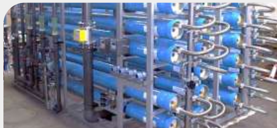
цех очистки производственно-бытовой воды
